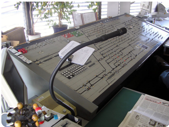
Bedienplatz eines Relaisstellwerks
