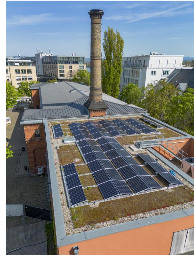
Photovoltaik-Anlage auf dem Dach des Kulturzentrums Mainz (KUZ). © mainzplus
