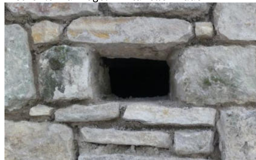
Nisthöhlen für Fledermäuse in Zitadellenmauer
