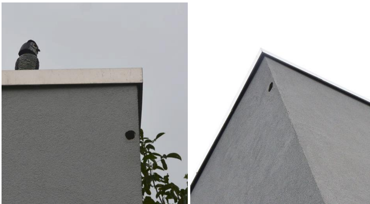
Abbildung 22: Spechthöhlen an der südlichen Fassade (links) und an der östlichen Fassade (rechts) des neuen Schützenhauses [Fotos: BG Natur].
