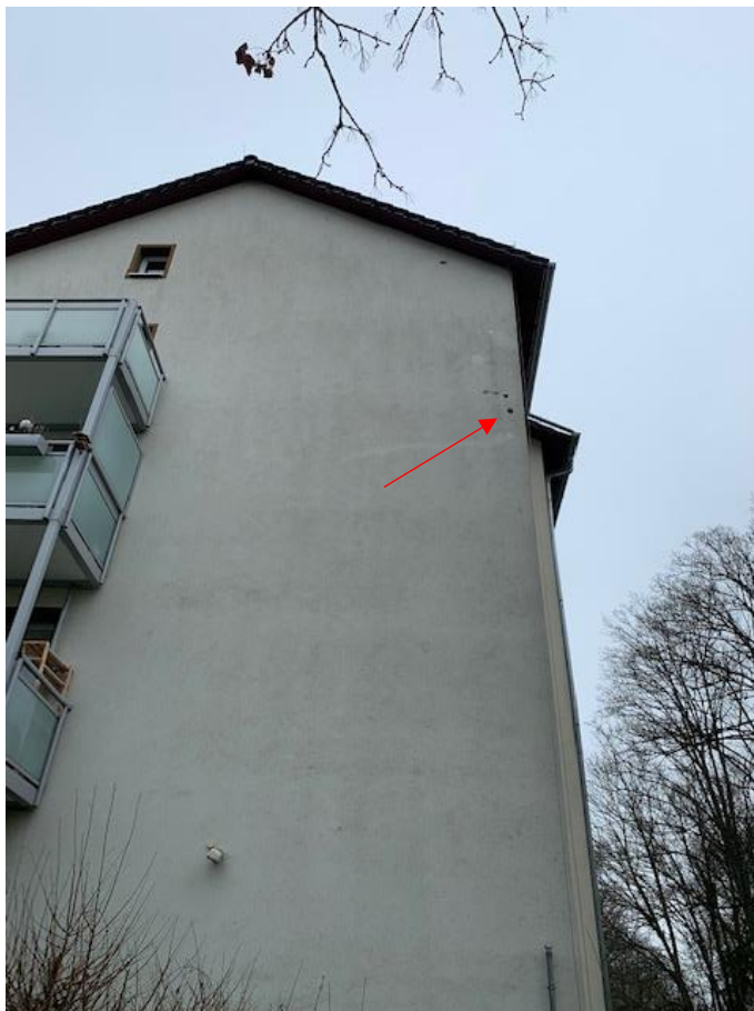
Abbildung 2: Mehrere Spechtlöcher in der Fassade von Gebäude Heinrich-Wothe-Straße 12. Das unterste wurde 2023 von einem Star als Brutplatz genutzt. Foto CW
