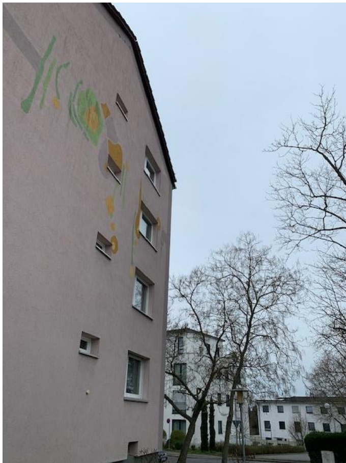
Abbildung 4: Spechtlöcher in der Fassade Ludwigsburger Str. 32. Diese wurden 2023 vom Halsbandsittich als Brutplatz genutzt. Foto CW
