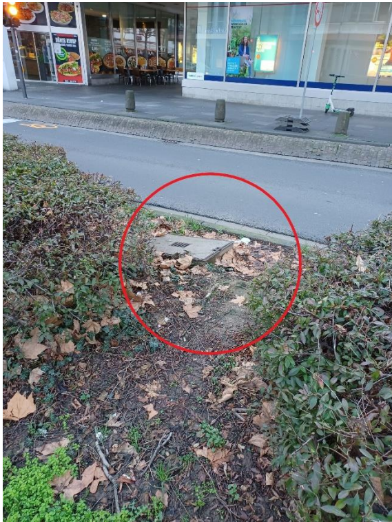
Abb. 54: Weißliliegasse, Baum 17. Bodenaufwölbungen, angehobene Schachtabdeckung rot umrandet.
