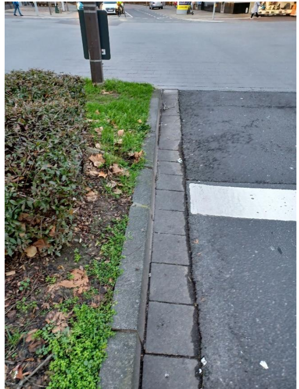
Abb. 55: Weißliliegasse, Baum 17. Bodenaufwölbungen.
