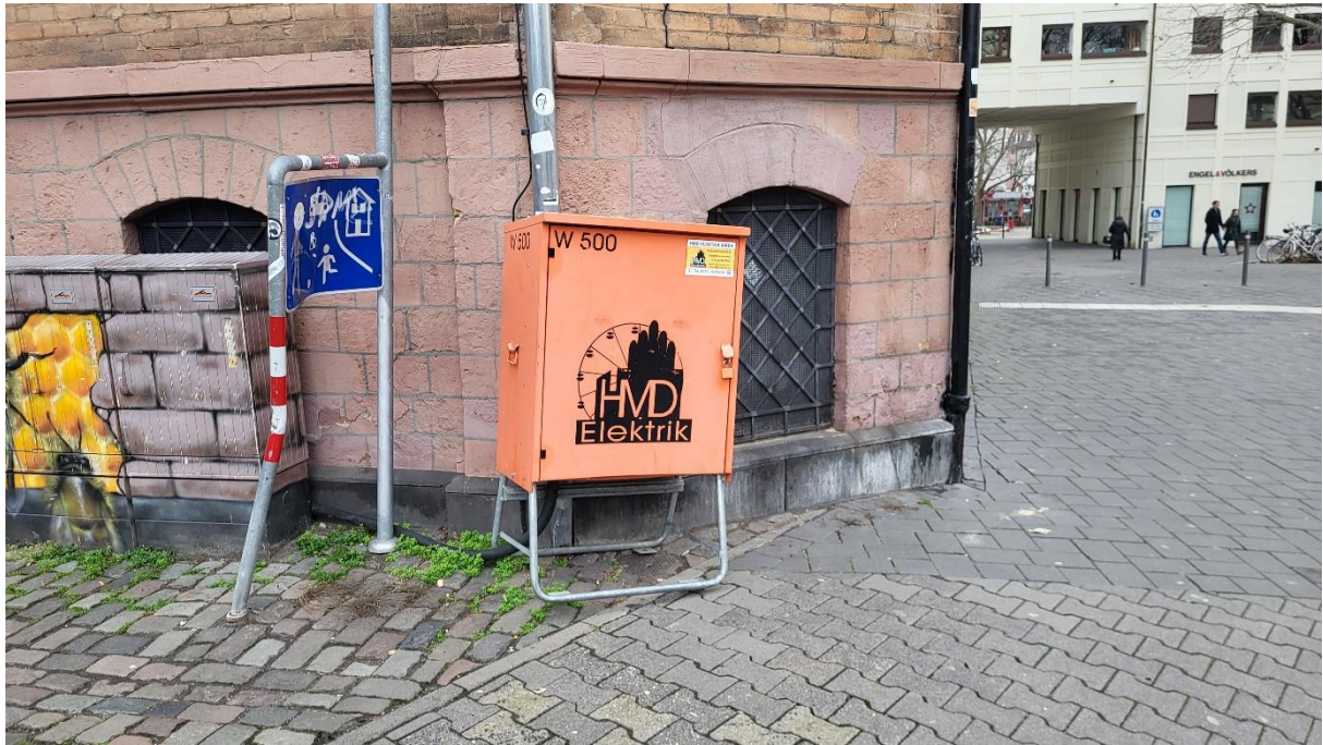
Bild 3: Zusätzlicher Sicherungskasten für Wintermarkt an der Ecke Holzhofstraße, Schönbornstraße
