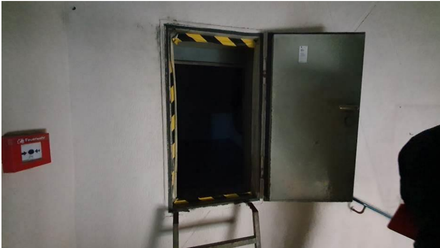
Foto 80: Tür zum Lüftungstechnikraum
