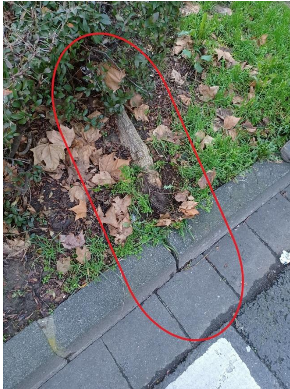
Abb. 56: Weißliliengasse, Baum 17. Bodenaufwölbungen rot umrandet.
