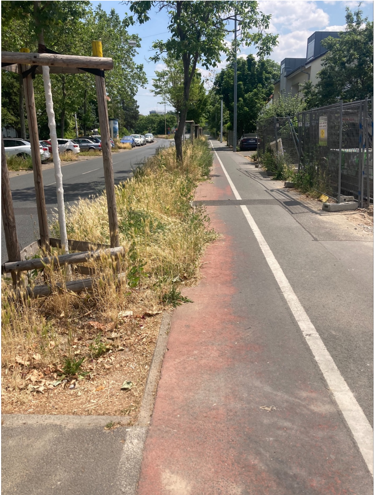
Fehlender Rückschnitt des Grüns an den Baumscheiben. Fahrradspur ist eingeschränkt nutzbar. Beispiel Straße an der Allee.
