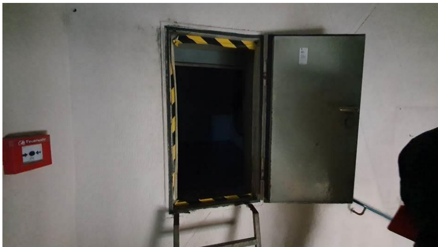
Foto 80: Tür zum Lüftungstechnikraum
