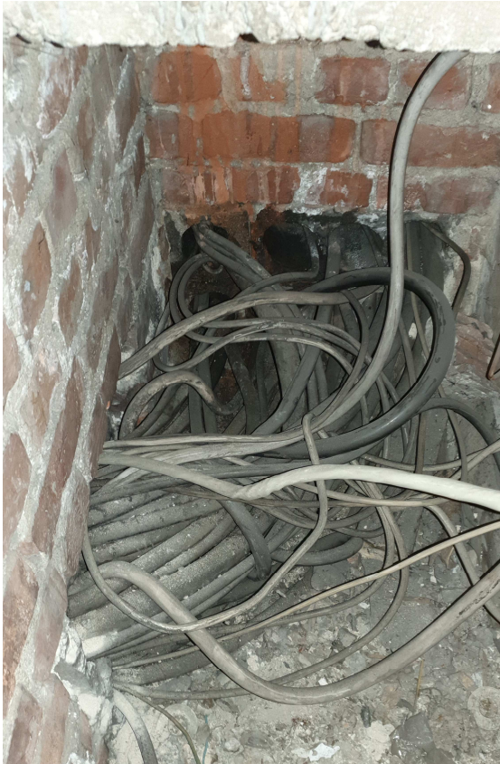
Foto 3: Intensive Kabelführung im Schacht
