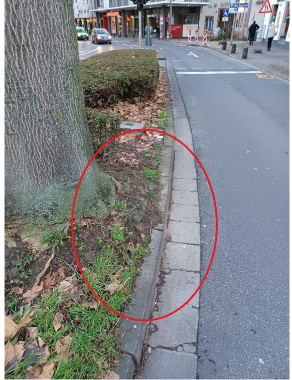
Abb. 53: Weißliliegasse, Baum 17. Bodenaufwölbungen rot umrandet.
