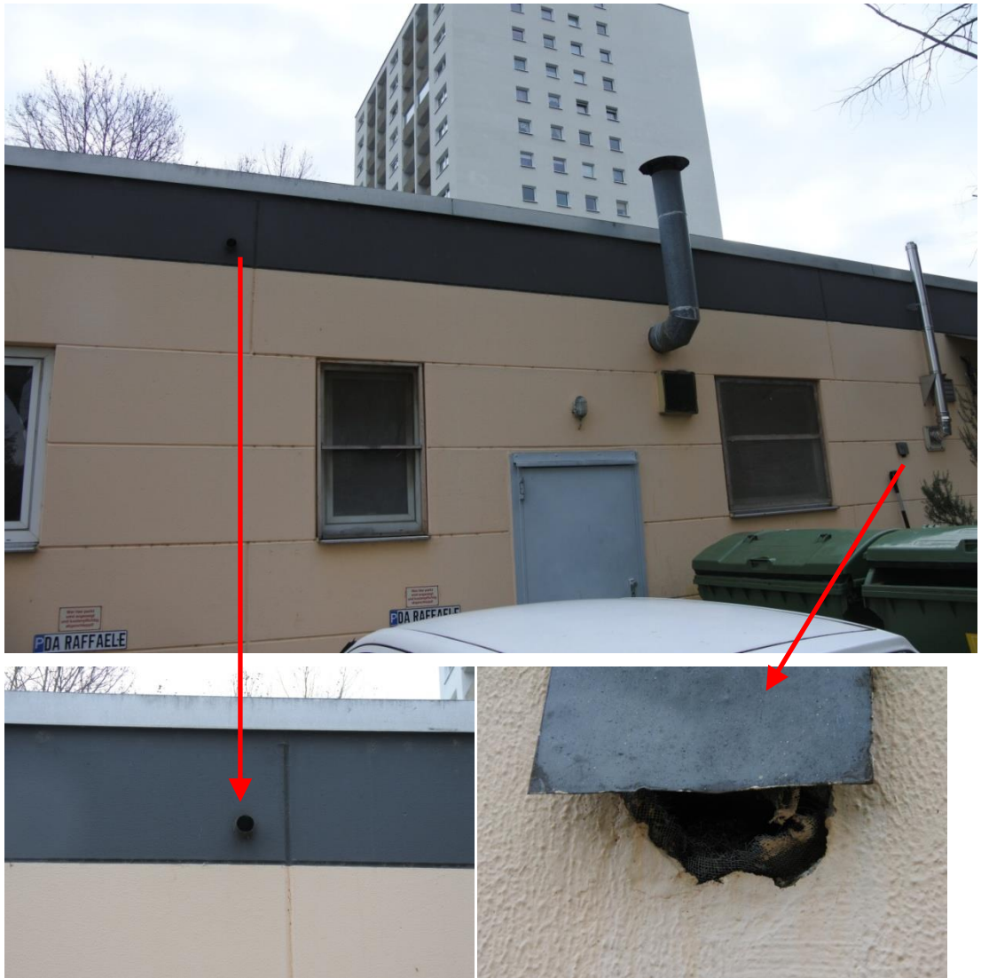
Abbildung 3: Gebäude Am sonnigen Hang 8 + 10 in Mainz. Oben: Detailansicht der Nordfassade. Unten links und rechts: Potentielle Einschlußmöglichkeiten in Rohrdurchlässen. Derzeit ist keine Nutzung als Fortpflanzungs- und Ruhestätte erkennbar. Eine zukünftige Nutzung als solche ist jedoch nicht auszuschließen. Daher ist im Falle eines Gebäuderückbaus eine erneute Untersuchung der Bereiche erforderlich. (Fotos: BG Natur).
