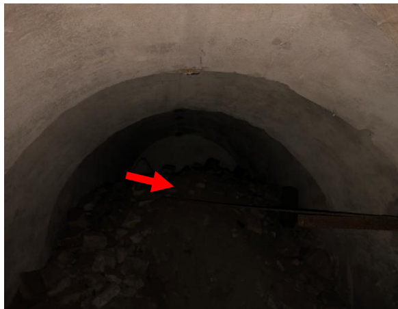
Bild 13: Schutt im hinteren Bereich
