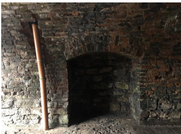
Bild 15: Entwässerungsleitung Rampe oberhalb
