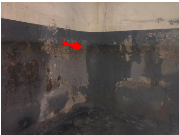
Bild 3: Drückendes Wasser, Pfeil: vermuteter Grundwasserhöchststand
