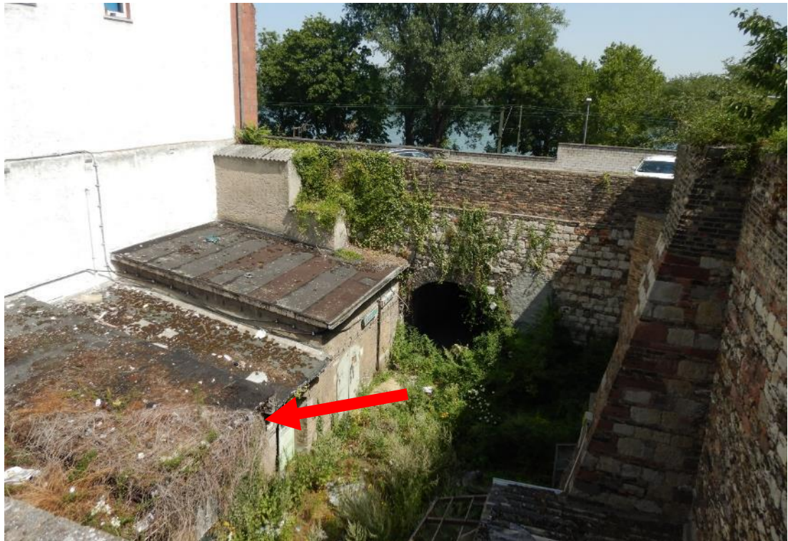
Abbildung 25: Geschützte Lage des Brunnenhauses im Lichthof.
