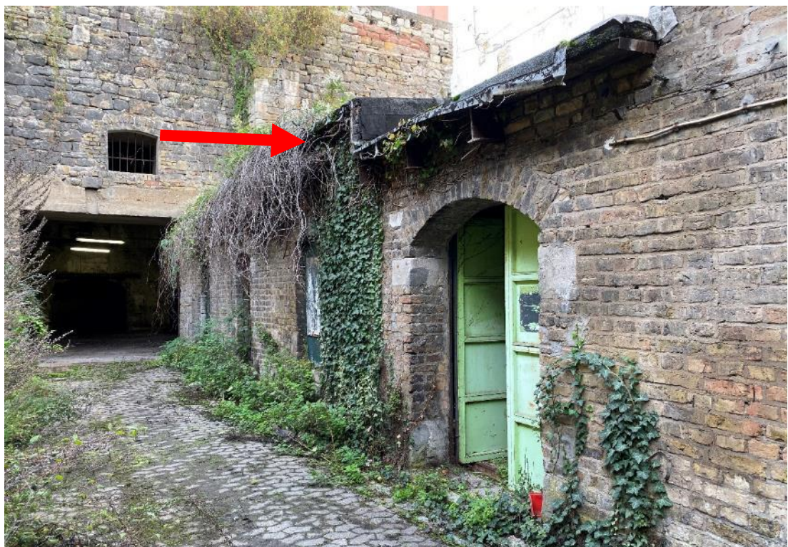
Abbildung 26: Fassade und Markierung eines zu schaffenden Einflugbereichs.
