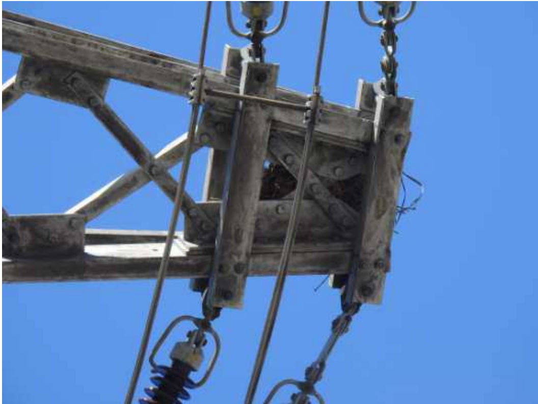
Bild 15: Der Turmfalken-Nistplatz auf einem Strommast am westlichen Rand des bestehenden Betriebsgeländes
