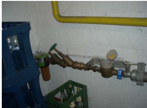
Abb. 28_Hausanschluss in der Fahrzeughalle Abb. 29_geschlossene Leckage
