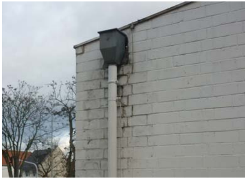
Abb. 19_Entwässerung an der Gebäudeecke mit Undichtigkeiten im Anschlussbereich / Wasserfangkasten
