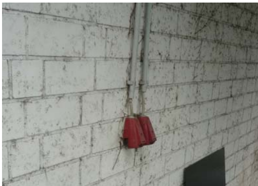
Abb. 27_Starkstromanschluss im Außenbereich überdacht
