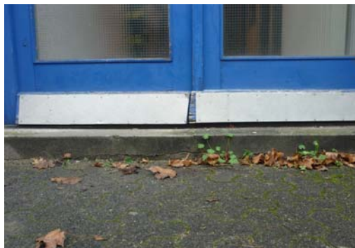
Abb. 15_undichter unterer Abschluss der Tür des Alarmeingangs
