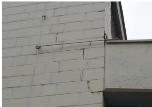
Abb. 12_Risse im Anschlussbereich Mauerwerk zu Beton
