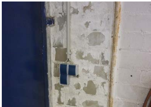
Abb. 21_Wandanstrich in der Fahrzeughalle
