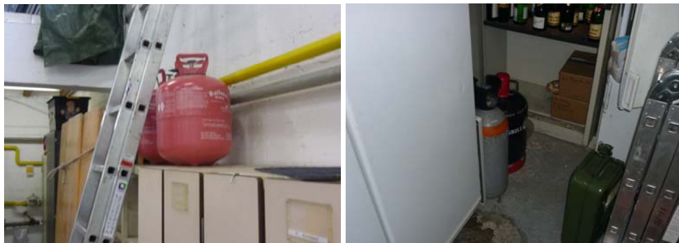
Abb. 36_ Offene Lagerung von Druckgasen in der Fahrzeughalle Abb. 37_ Lagerung von Druckgasen und Treibstoffen neben Getränken im Lagerraum
