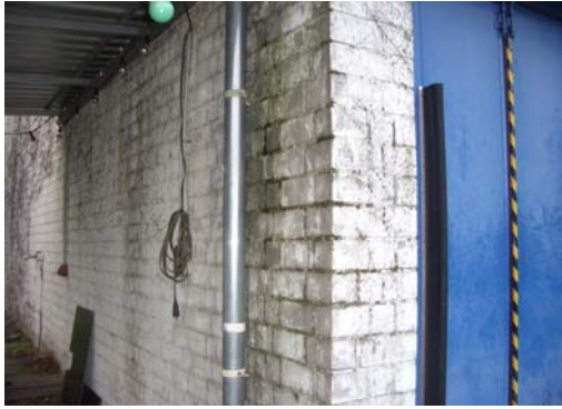
Abb. 13_Feuchtigkeit führt zu Moos und Algen auf der Außenfassade
