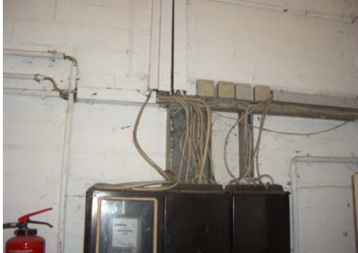
Abb. 26_nicht VDE-Konforme Leitungsführung
