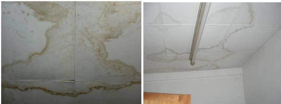
Abb. 17_Undichte Stelle im Heizungsraum
