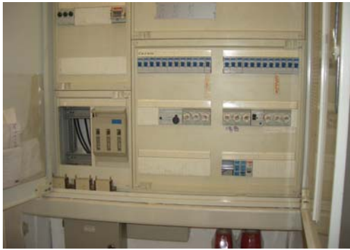
Abb. 16_Niederspannungshauptverteilung in der Fahrzeughalle
