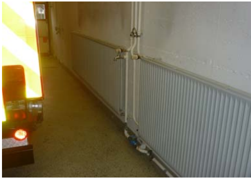
Abb. 15_Heizkörper in der Fahrzeughalle
