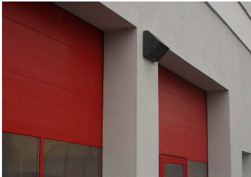
Abb. 5_Beleuchtung des Alarmeingangs
