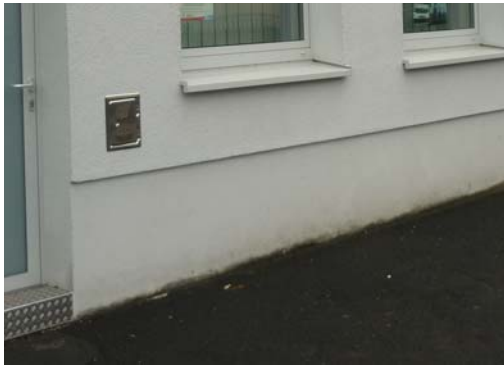
Abb. 9_Feuchtigkeit führt zu leichter Moosbildung im Sockelbereich der Außenfassade
