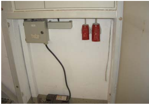
Abb. 18_Starkstromanschluss in der Fahrzeughalle, nicht VDE-Konforme Batterieeinspeisung
