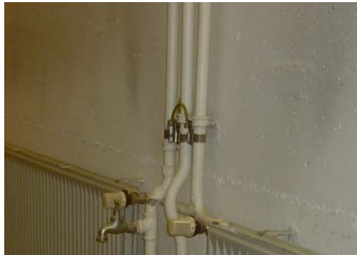
Abb. 14_Wärmeverteilnetz in der Fahrzeughalle
