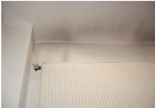
Abb. 5_Sogenannter „Schwarzstaub“ über den Heizkörper
