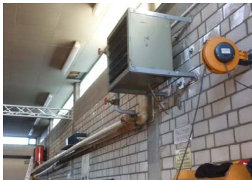
Abb. 8_Heizlüfter in der Fahrzeughalle
