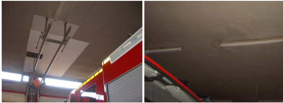
Abb. 19_ Fehlende und erneuerte Deckenplatten in der Fahrzeughalle Abb. 6_ Wasserflecken aufgrund des undichten Flachdachs
