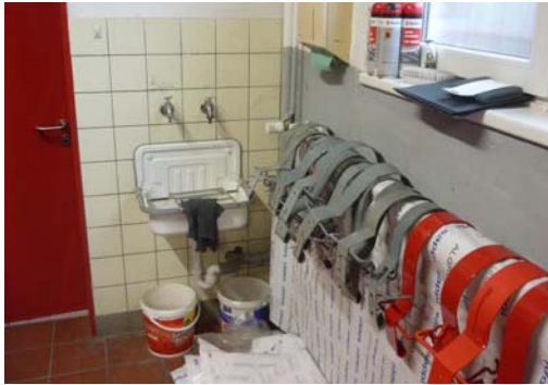
Abb. 29_Waschbecken in der Fahrzeughalle direkt neben dem Eingang zur Werkstatt
