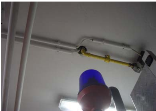
Abb. 19_ Betondecke der Fahrzeughalle mit nicht fachgerechter Durchdringung
