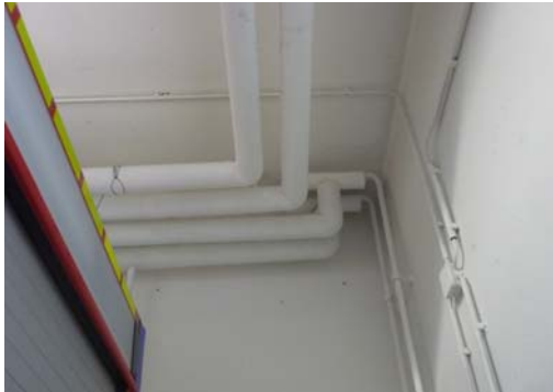
Abb. 22_Wärmeverteilnetz in der Fahrzeughalle
