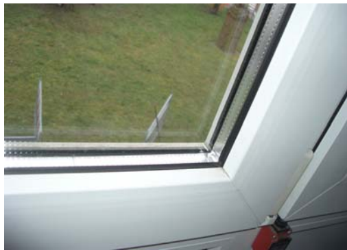
Abb. 14_zweifach verglastes Kunststofffenster in der Küche
