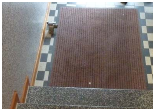
Abb. 10_Türstopper der nach innen aufschlagenden Fluchtwegtür
