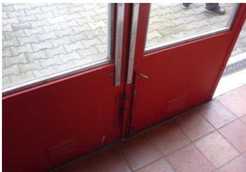
Abb. 44_Falldore mit Quetschstellen
