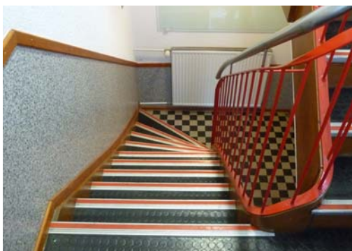
Abb. 33_Treppenstufen mit rutschhemmenden Gummibelag und Stufenprofilen
