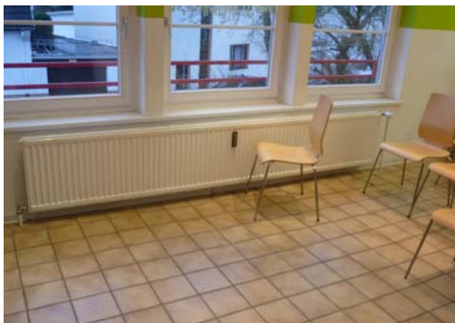
Abb. 23_Heizkörper im Unterrichtsraum II
