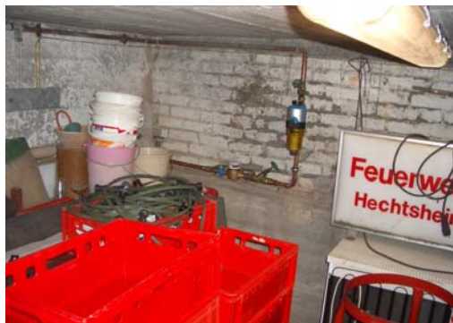
Abb. 28_Hausanschluss im Kellergeschoss
