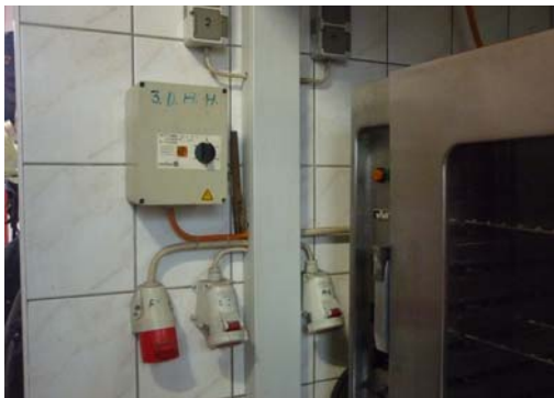
Abb. 27_Starkstromanschluss in der Fahrzeughalle, VDE-Konforme Leitungsführung
