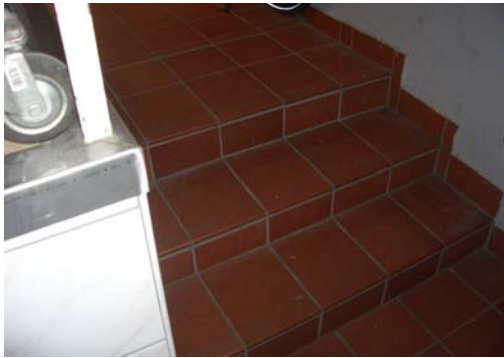
Abb. 34_Ausgleichstreppe in der Fahrzeughalle ohne Warnkennzeichnung
