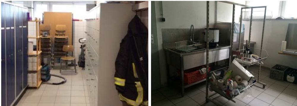
Abb. 36_Stühle im Umkleide / Duschbereich der Herren, zugestellte Fläche im Abstellraum im EG
