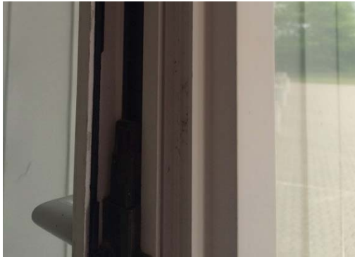
Abb. 13_zweifach verglastes Kunststofffenster des Schulungsraums, Dichtgummi spröde
