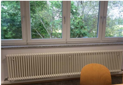
Abb. 20_Heizkörper im Schulungsraum 1. OG
