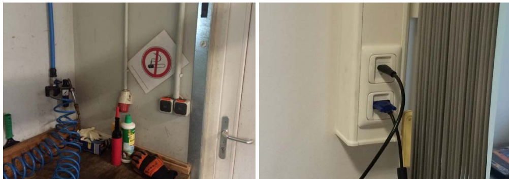
Abb. 22_ Leitungsführung Fahrzeughalle unteres Bild Datenanschluss Schulungsraum
