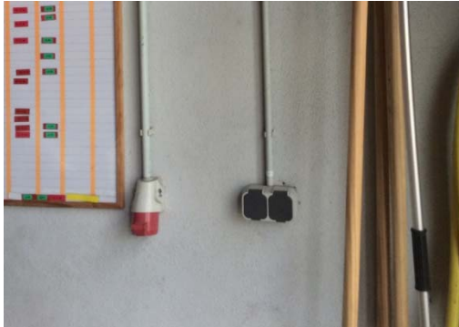
Abb. 23_Starkstromanschluss in der Fahrzeughalle
