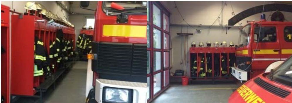
Abb. 40_zu geringer Wandabstand aufgrund fehlerhafter Aufstellung der Spinde
