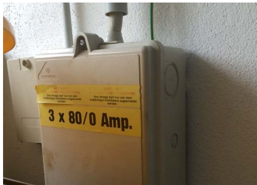
Abb. 21_Niederspannungshauptverteilung im Abstellraum
