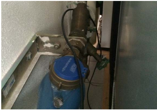
Abb. 24_Verteilnetz Wasser im Abstellraum im EG
