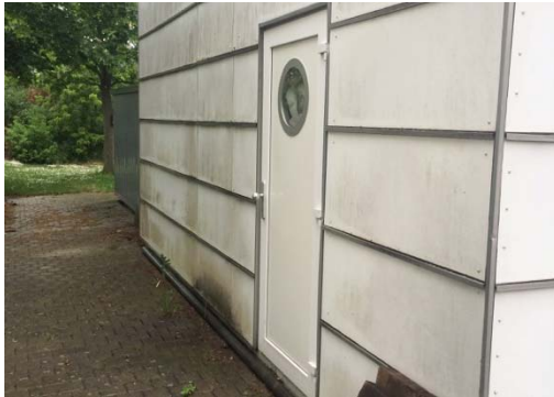
Abb. 12_Feuchtigkeit führt zu Moosbildung im rückwertigen Bereich der Außenfassade mit Verkleidung aus Faserzementplatten
