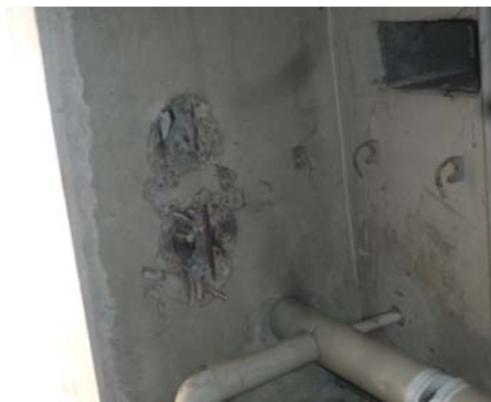
Abb. 11_Offene Durchdringungen im Deckenbereich der demontierten Be- und Entlüftungsanlage
