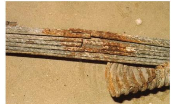
Drahtbündel aus Schadensfall (Nürnberger et. al. 1994)
