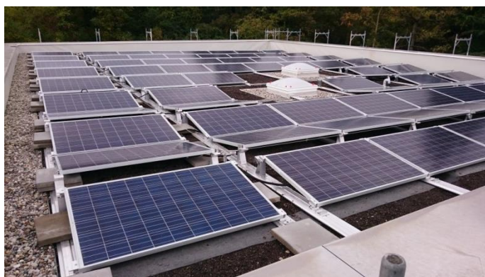
Abbildung 54: PV-Anlage auf dem Umweltbildungszentrum (Quelle: Entsorgungsbetrieb der Stadt Mainz)
