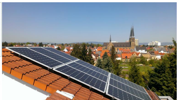
Abbildung 5: PV-Anlage auf dem Dach (Quelle: in.power GmbH)
