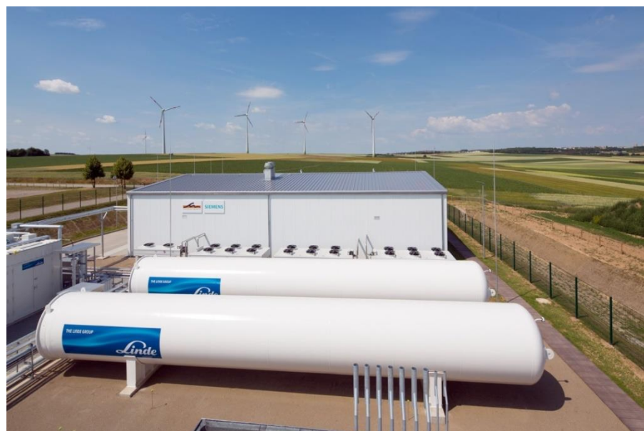
Abbildung 12: Energiepark Mainz: Elektrolysehalle mit Rückkühlern und Wasserstofftanks (Quelle: Mainzer Stadtwerke AG)
