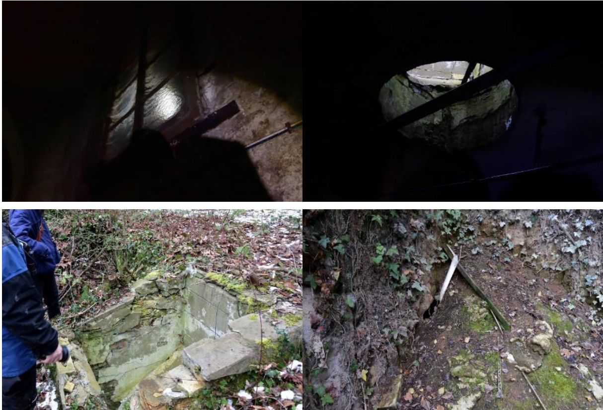
Abbildung 15: Beispiele für Einflugmöglichkeiten ins Kellergewölbe von innen (oben) und von außen (unten).
