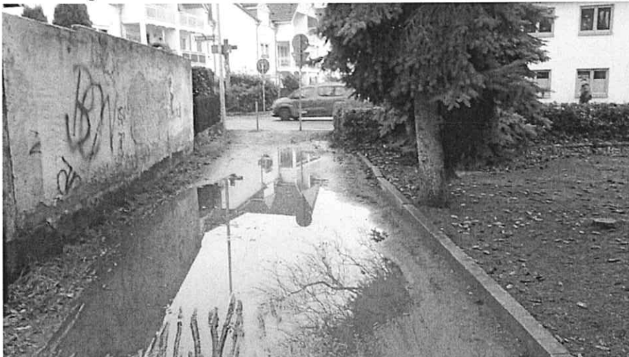
Zustand Weg (Punkt 1) nach Regenfall.
