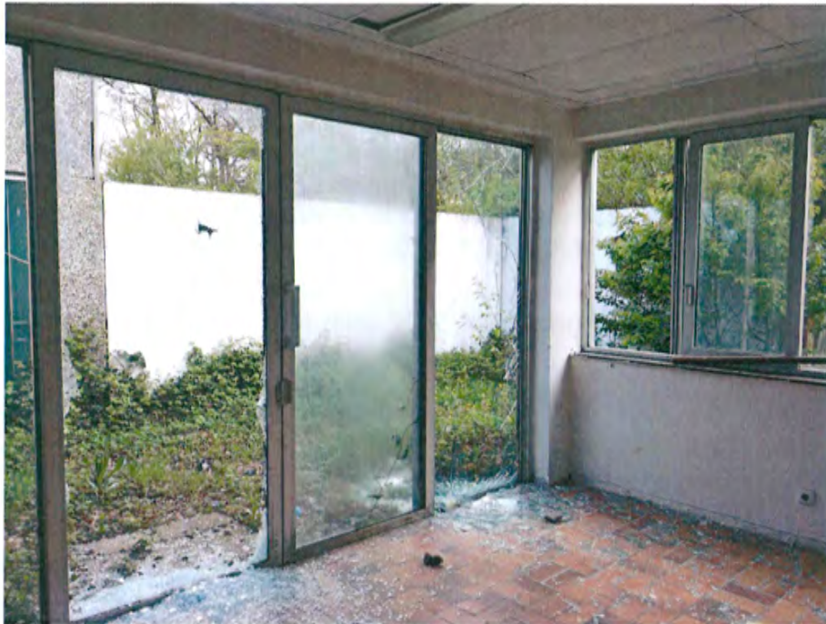
Gebäude 5826 nach Einbruch
