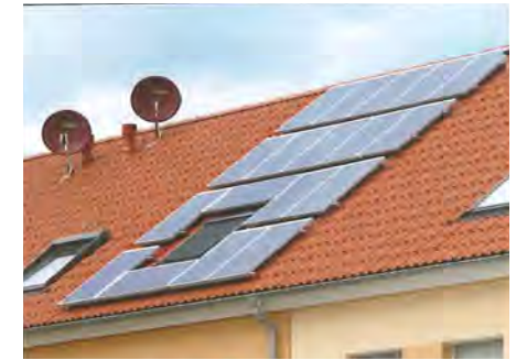
z.B. vollflächige Nutzung der Dachfläche durch Fotovoltaikanlagen
