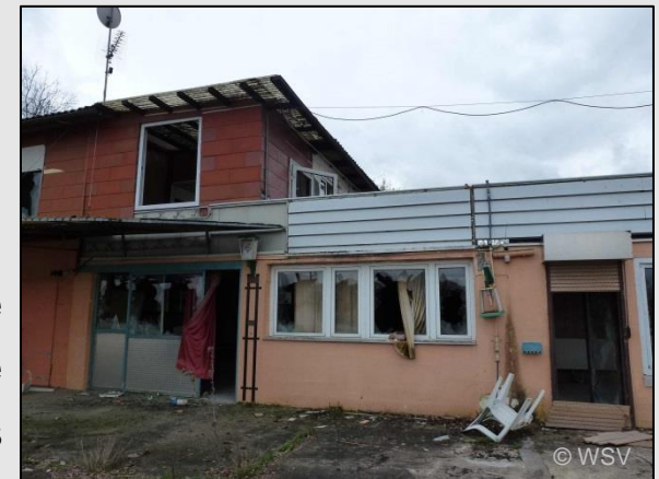
▶▶ Blick auf das marode Gebäude auf dem Gelände des Campingplatzes
