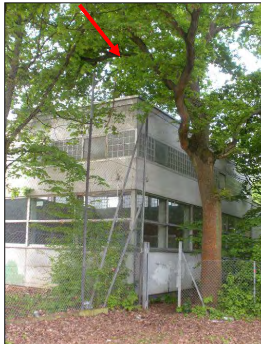
Eiche 120 an Nordstecke Sporthalle, Äste über Dach
