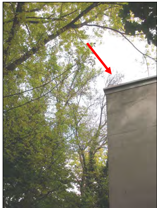
Südwestecke Sporthalle, Äste über Dach
