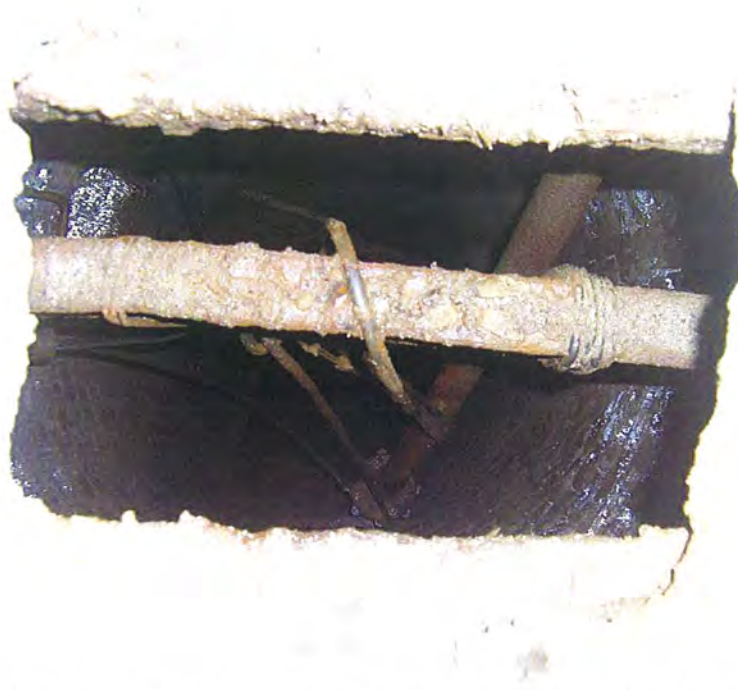
Bild 10: Blick in den ehemaligen Betriebsbrunnen. Diverse Kabel und Rohre sind erkennbar. Der Brunnen ist in den oberen Metern augenscheinlich gemauert.
