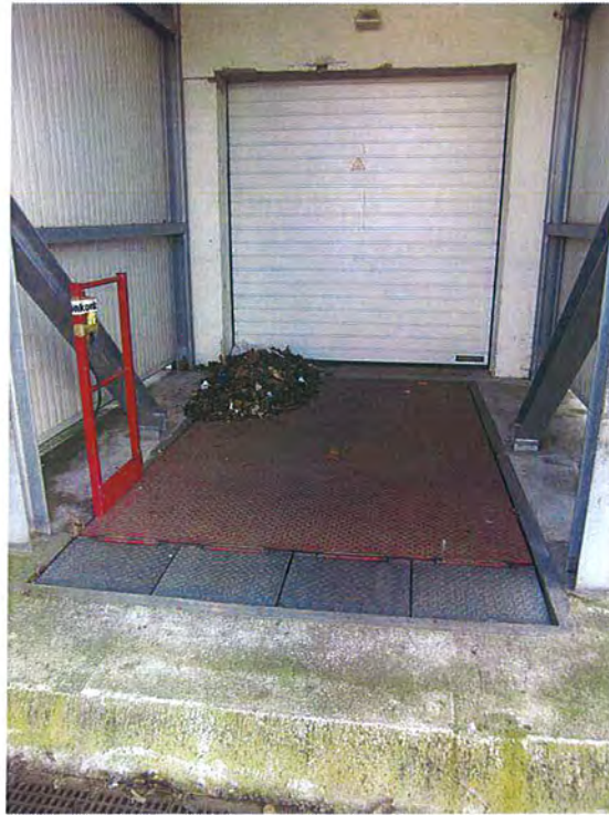
Bild 7: Blick auf die Hebebühne bei der Warenanlieferung bzw. Warenabholung. Die Warenanlieferung / -abholung befindet sich etwa 1,5 m unter der GOK des Parkplatzes. Es handelt sich um eine elektrisch betriebene Hebebühne.
