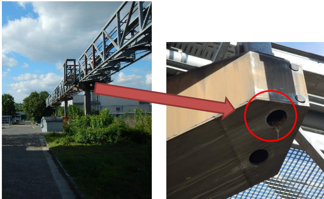
Abbildung 8. Die Pfeiler oberirdischer Kabelbrücken bieten Platz zum Nestbau [Fotos © N. Zeuner (Fa. BG Natur), 2016].
