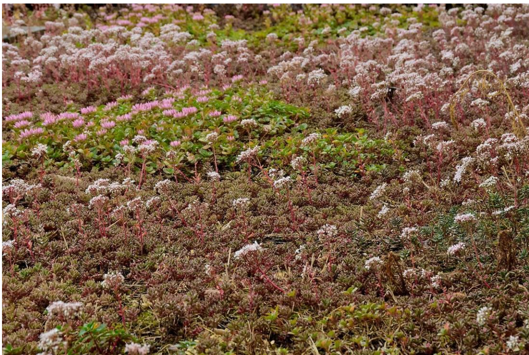
Abbildung 19: Beispiel einer Dachbegrünung (oben Wiesbaden Erbenheim, unten Detailansicht Garagendachbegrünung in Nackenheim) [Fotos © J. Tauchert (Fa. BG Natur), 2016].
