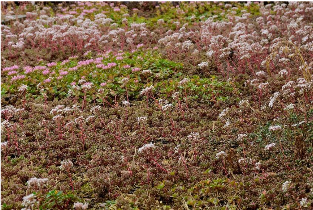
Abbildung 13: Beispiel einer Dachbegrünung (Wohngebiet Wiesbaden Erbenheim sowie Detailansicht Garagenbegrünung Nackenheim) [Fotos J. Tauchert (Fa. BG Natur), 2016].
